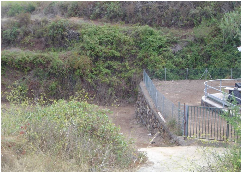
Imagen de Invasión del cauce por edificaciones
